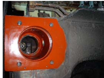
タイバーナット座面補修例
